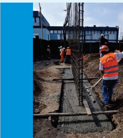
Bases de concreto para la construcción del Búnker en donde se implementará los servicios de Imagenología, Radioterapia y Laboratorio del IREN Norte
